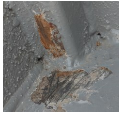
Рисунок 1 – Зона дослідження корозії в металевій конструкції
